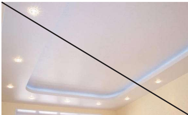
Плохо Многоуровневые гипсокартонные конструкции
