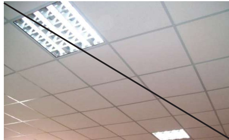
Плохо Открытые направляющие
